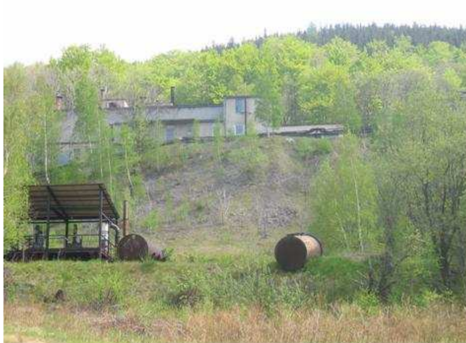
Rys.10. Szkody w pokrywie roślinnej na zboczu hałdy 03003, na terenie wzbogacania rudy uranowej w Kowarach
