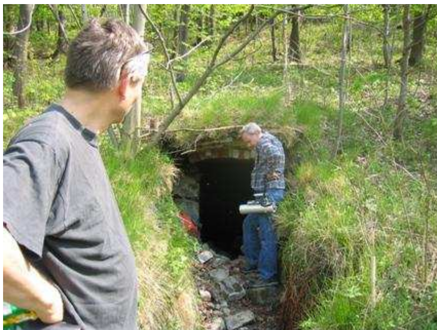
Rys. 6. Rozbite zabezpieczenie wejścia do sztolni przy drodze dojazdowej do byłego zakładu wzbogacania rudy uranowej (Nr 03005)
